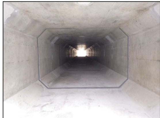
羽越線 西鶴岡信号場構内 排水路 (山形県鶴岡市)
